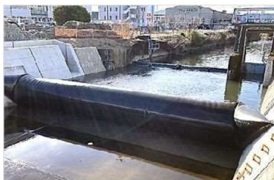
写真1 ゴム引布製起伏堰（志太榛原農林事務所）
