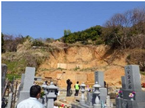
静岡市清水区墓地土砂崩れ現地調査(2022)
