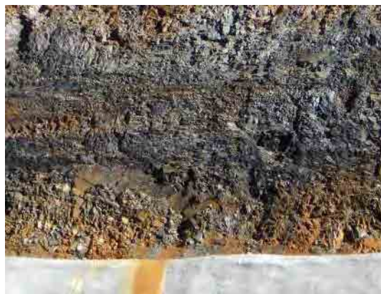
写真-2 黒色泥岩法面 法面表面が褐色化し酸性化が進行
